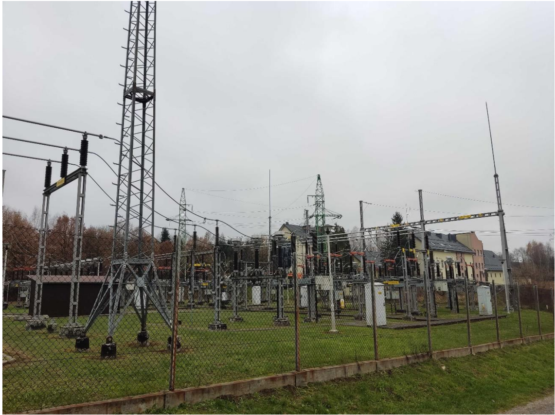
Ryc. 3 Stacja elektroenergetyczna w granicach opracowania
